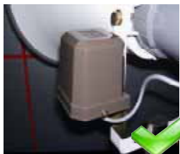
Pemasangan di angle speaker
